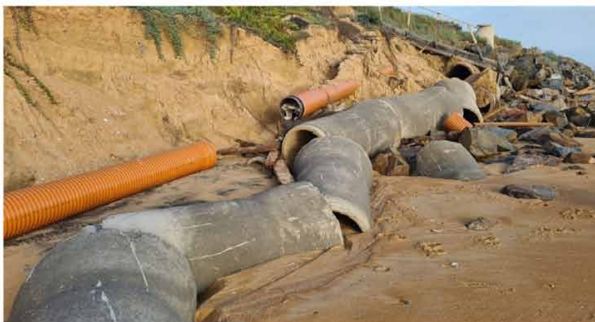
photo_camera Daños en el colector de las casas de Bonares Los trabajos de reparación han comenzado hace unos días
