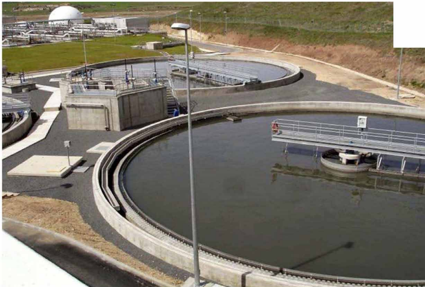
Vista de la depuradora de Ciudad Real.
