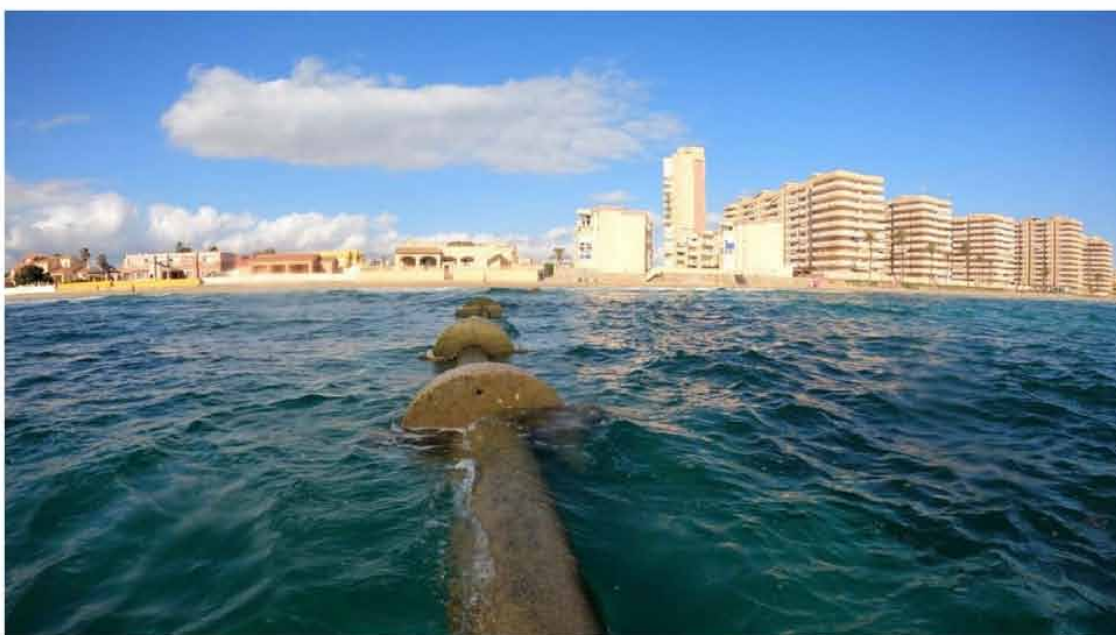
Emisario con fugas de aguas residuales procedentes de la red de alcantarillado de La Manga ANSE
