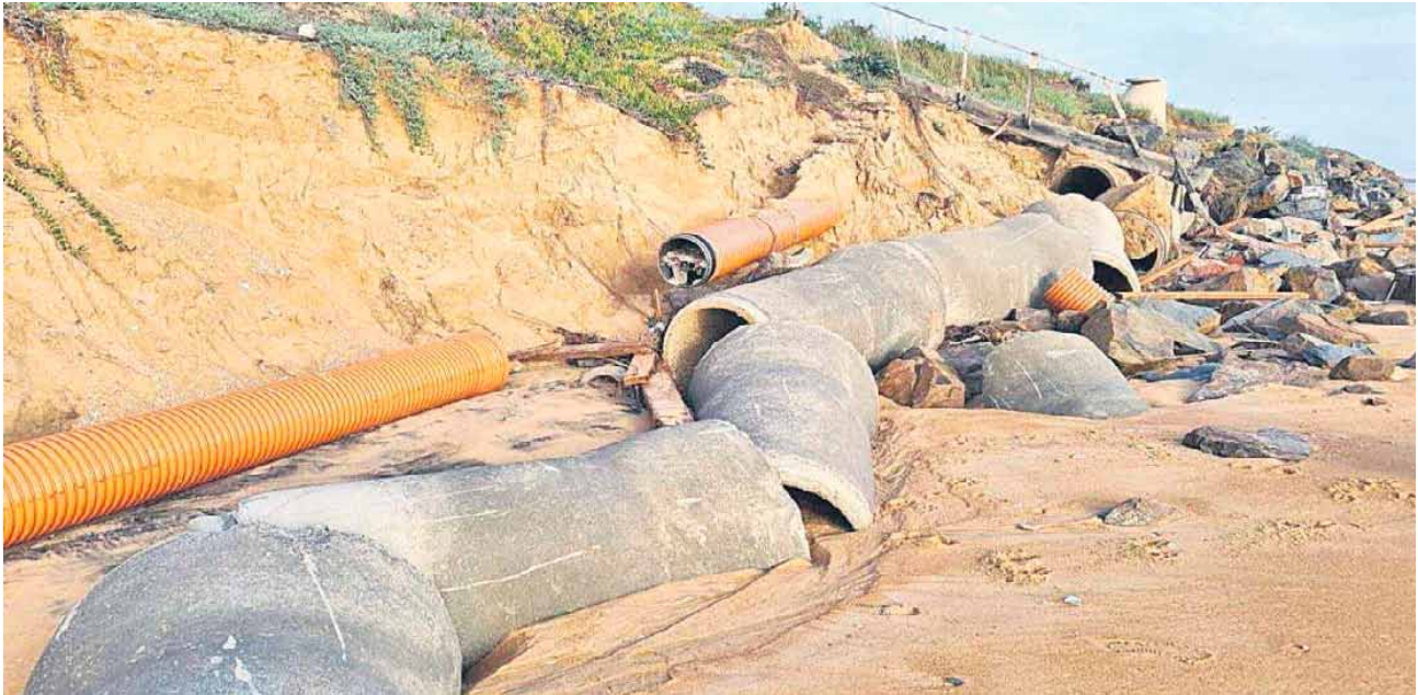
Colector residual dañado por el temporal en la playa.
